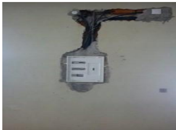
Fig.13 Quadro elétrico depois de ser ligado
