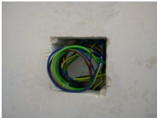
Fig.10 Caixa de derivação antes de ser ligada.
