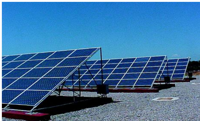
Fig.6 Painéis solares fotovoltaicos.
