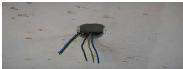
Fig.9 Caixa de tomada com condutores (neutro, fase e terra).
