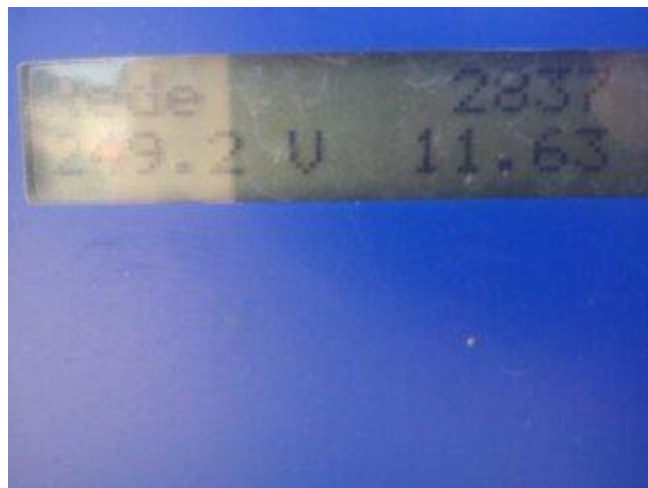
Fig.19 Inversor em funcionamento.
