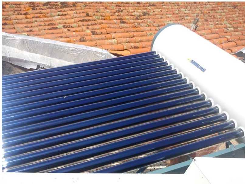
Fig.20 Coletor solar térmico depois de ser instalado.
