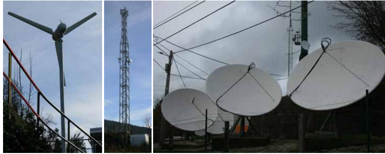
Figura 7 – Aerogerador, torre de telecomunicações e parabólicas.
