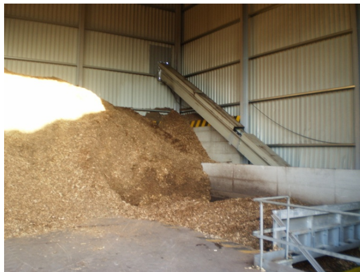
Imagem 47 – Armazém de biomassa com estilha de madeira
