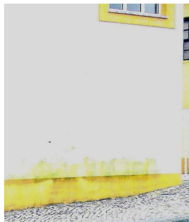
Figura 1.3- Exemplo de humidade do terreno. Fonte: (Dinis, 2010).
