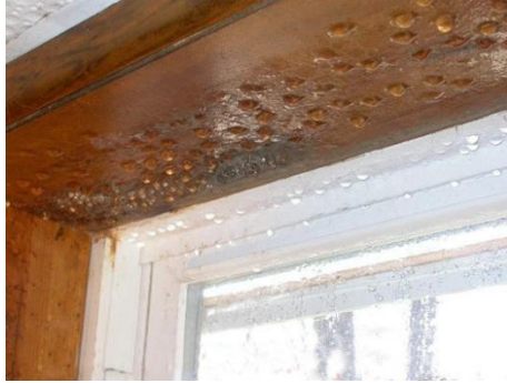
Figura 1.5- Exemplo de humidade de condensação.
