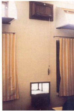
Figura 2.45- Coletor de ar visto do interior. Fonte: (Gonçalves & Graça, 2004).
