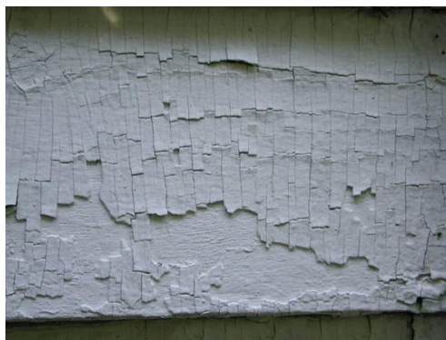
Figura 1.6- Exemplo de humidade devida à higroscopicidade dos materiais.
