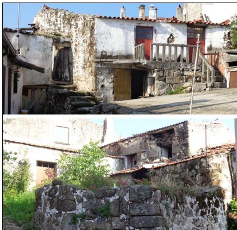
Figura 67 - Casas em ruínas
