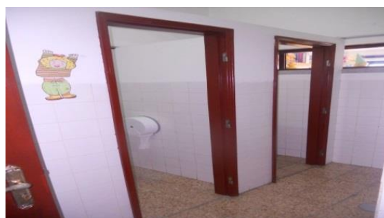
Figura 5: Instalações sanitárias Fonte: Própria
