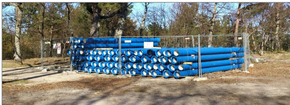
Figura 17 - Condutas Adutoras (Ferro Fundido Dúctil)
