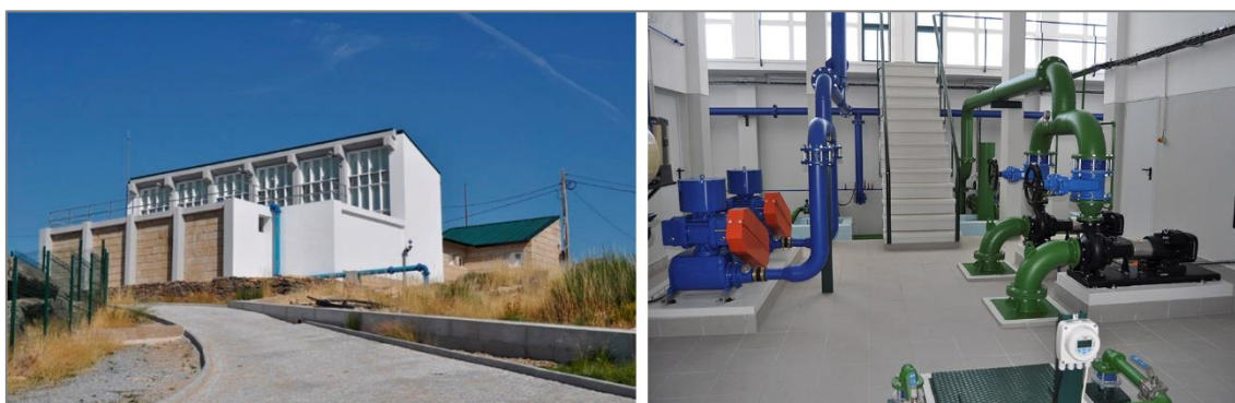
Figura 15 - Estação de Tratamento de Água Penhas da Saúde
