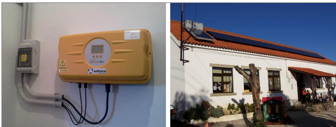
Figura 2 - Projeto Covilhã Solar - inversor (esquerda) e painel/coletor solar (direita)
