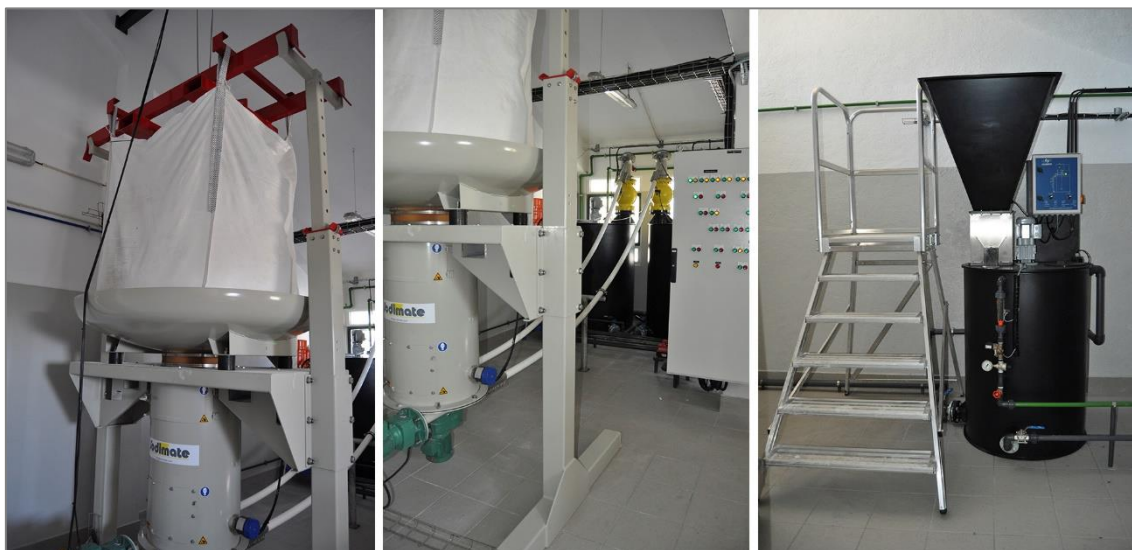
Figura 42 - Tratamento de água (ETA)
