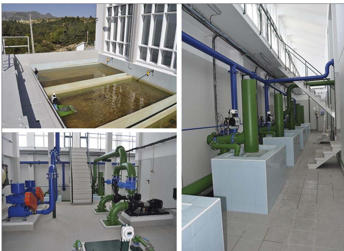
Figura 43 - ETA (filtros de areia, bombas e descarregadores)
