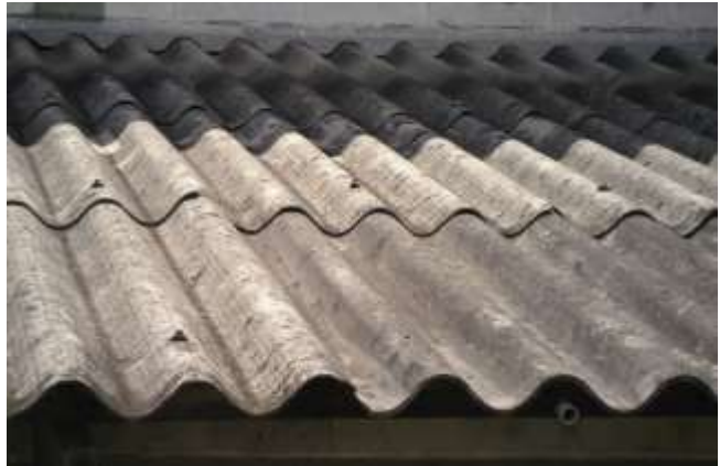
Figura 14 - Exemplo de aplicação do amianto
