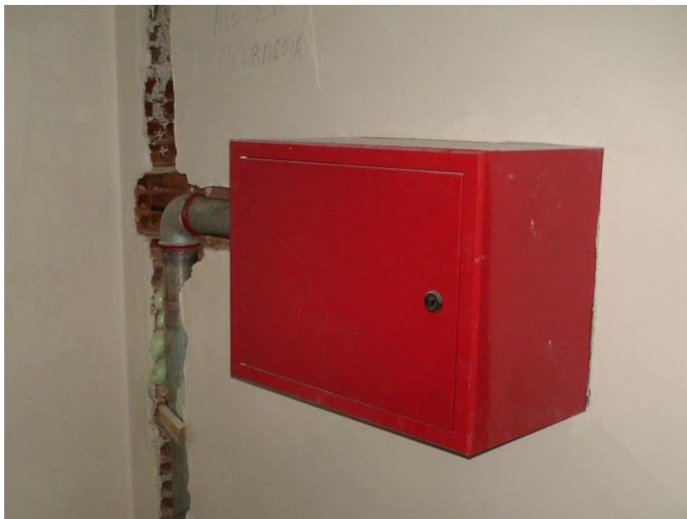
Figura 49: Caixa da válvula siamesa aplicada no patamar da escada de acesso ao piso 1.
