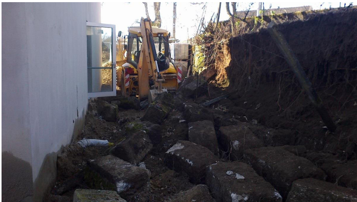
Figura 38: Pedras que constituíam o muro e saída de emergência da ala de quartos do lar residencial.
