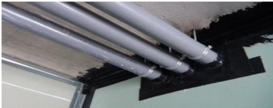
Figura 35 - Aplicação de banda betuminosa flexível na ligação da tubagem de ventilação com a parede [5]
