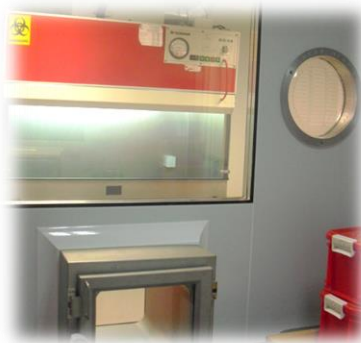
Figura 8: Sala de preparação de citotóxicos
