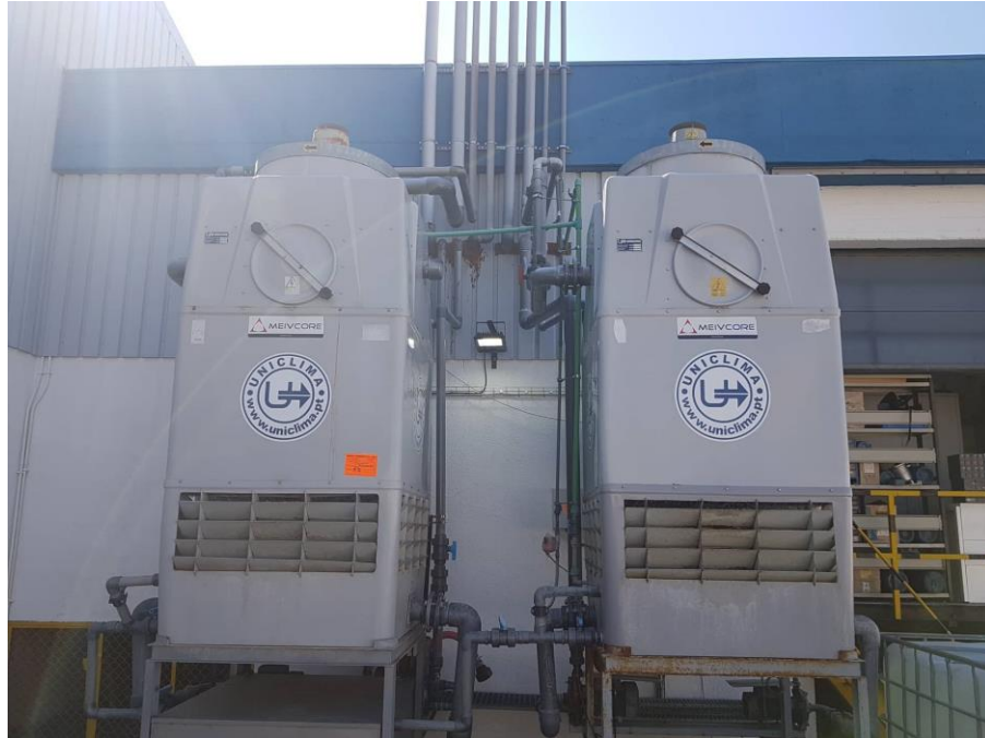
Figura 26 - Torres de arrefecimento exteriores
