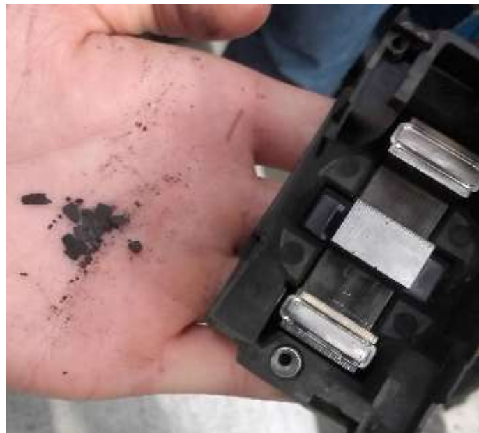
Figura 23 - Armadura do contactor e sujidade contida
