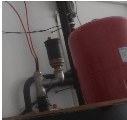
Figura 26:T onde está montada a resistência e o purgador. (Fonte: Própria)
