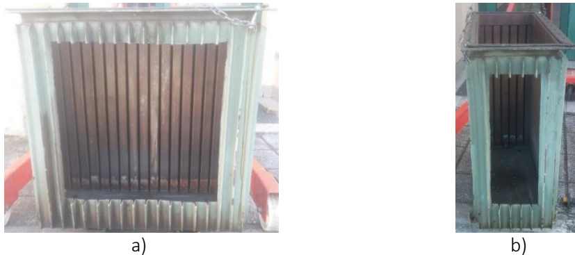
Figura 20: Aberturas no transformador.
