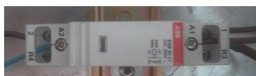
Figura 64: Contactor bomba hidráulica. (Fonte: Própria)
