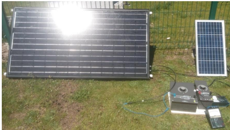
Figura 32: Teste do PV de 200W e do PV de 30W em carga. (Fonte: Própria)
