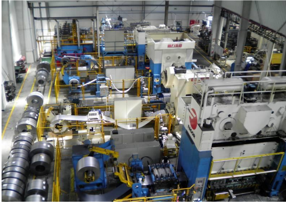
Figura 4- Instalações do interior da SODECIA da Guarda, especificamente as prensas
