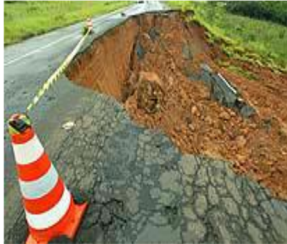
Imagem 8: Exemplo de trecho de estrada em aterro, implantada a vários anos, por infiltração de água através do pavimento trincado (Estado de São Paulo, janeiro de 2007 - UOL)
