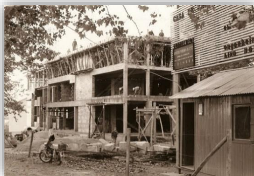
Figura 1- Construção do Edifício após o Incêndio
