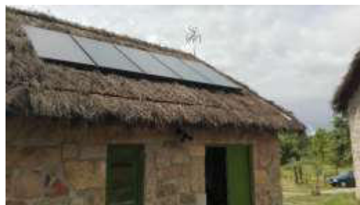
Figura 51 – Fontes alternativas de energia (Painéis Solares)
