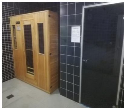
Figura 8- Banho Turco / Sauna (fonte própria)
