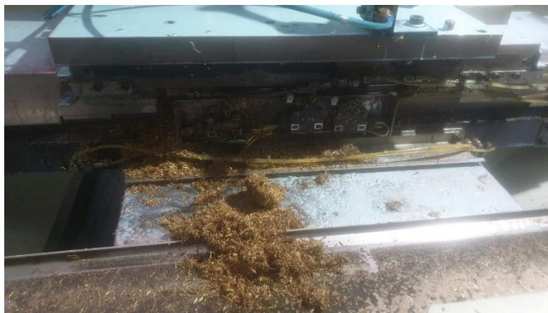
Figura 20- Limalha existente nessa zona
