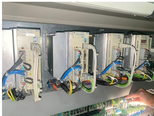
Figura 18 - Drivers com sistema de comunicação com cabos USB
