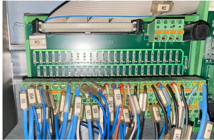
Figura 60 - Placa de entradas do PLC
