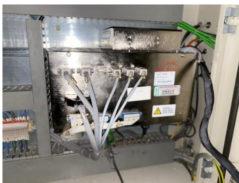
Figura 13 – Elemento de controlo com sistema de comunicação com cabos RS232
