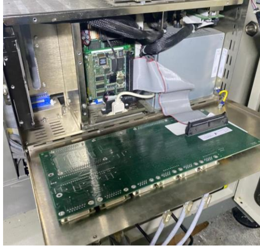
Figura 48 – Elemento de controlo com PLC incorporado
