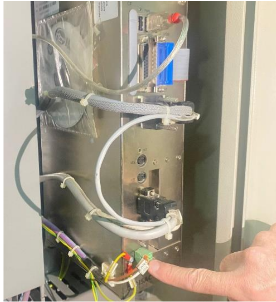
Figura 17 – Elemento de controlo com sistema de comunicação CAN Bus
