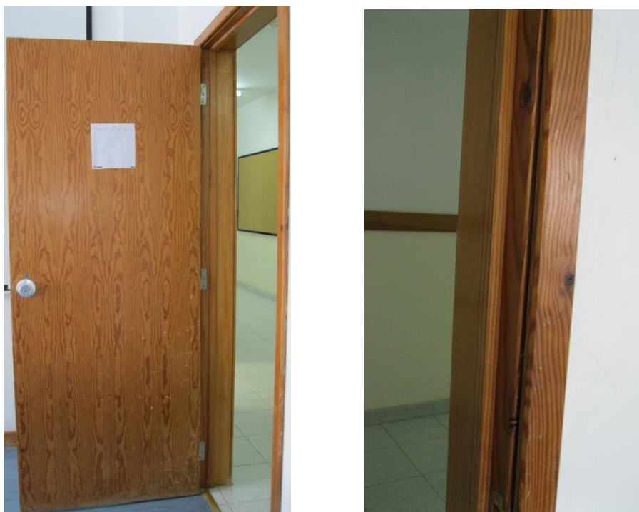
Figura 18- Porta sem vedante em todo o seu perímetro e sem grelha.
