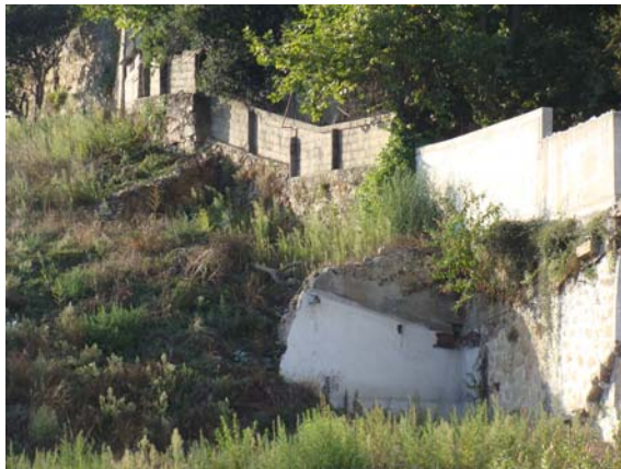
Figura 4 – Risco de Queda em Altura
