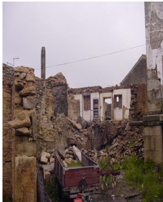
Fig. 2 – Edifício Adjacente em Ruína (Vista Sul)
