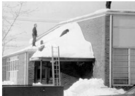
Fig. 23 – Exemplo de Neve em Cobertura
