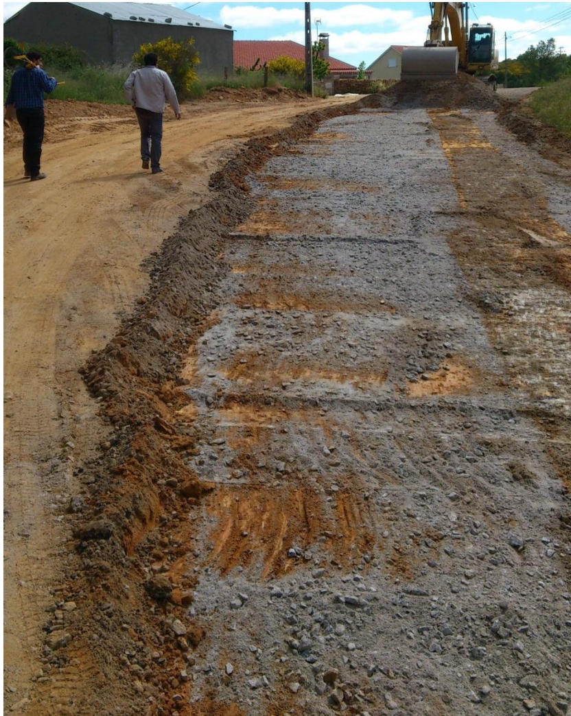
Figura 18 - Abertura de caixa
