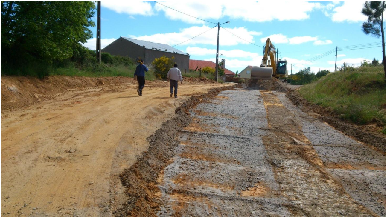
Figura 19 - Abertura de Caixa
