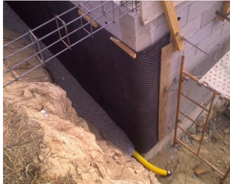
Figura n.º 7 - Drenagem no muro de suporte.
