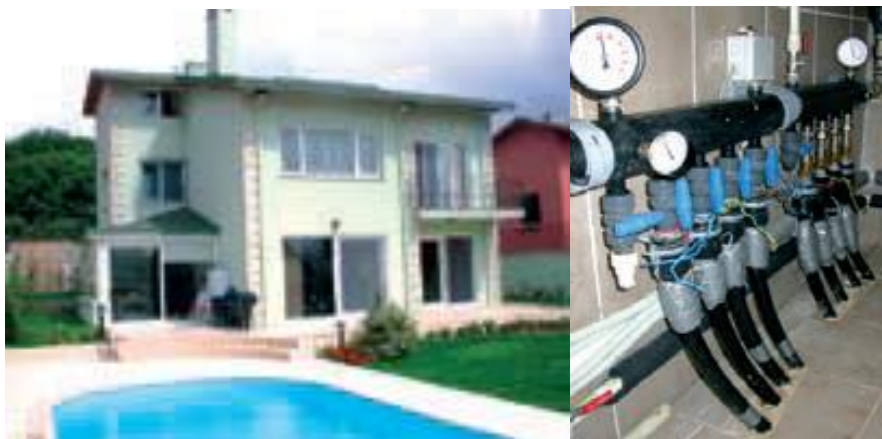
Figura 8. Habitação na Turquia com circuito vertical [7]
