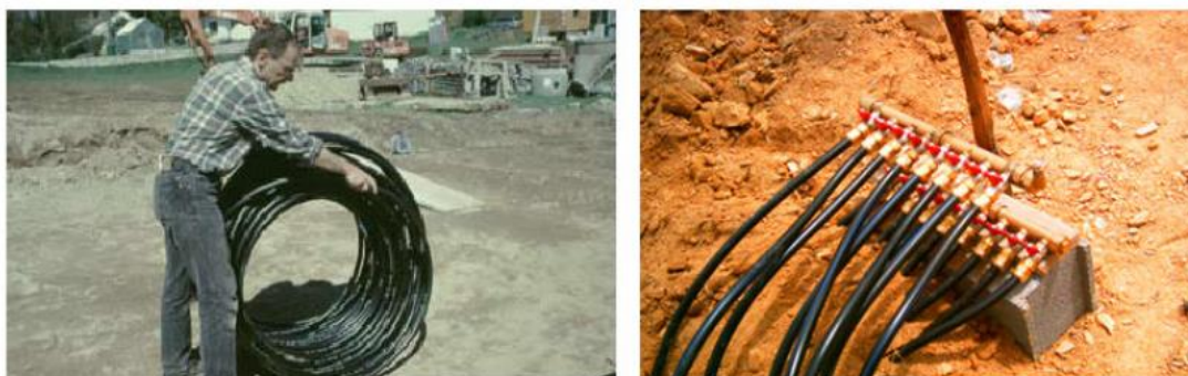
Figura 39. Ligação aos coletores de distribuição [16]
