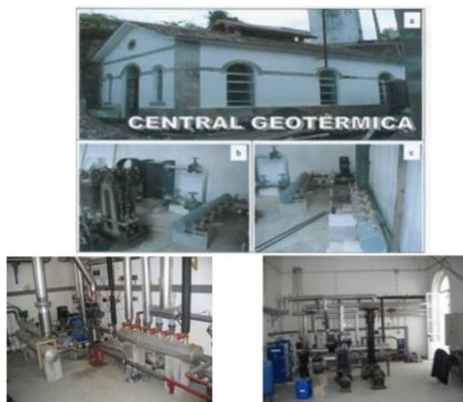
Figura 124. Central geotérmica de S. Pedro do Sul
