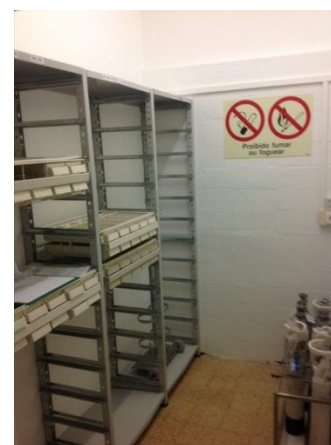
Figura 15 Sala de Gases Medicinais
