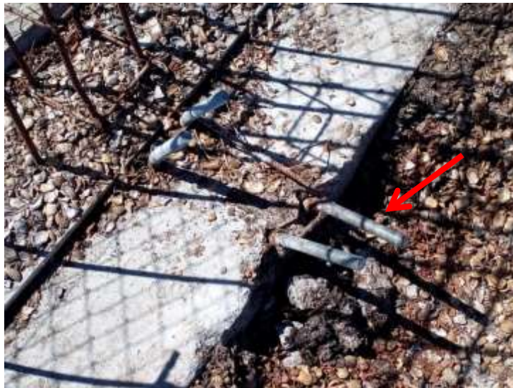
Fig. 37 Exemplo do estado dos parafusos (fonte própria)
