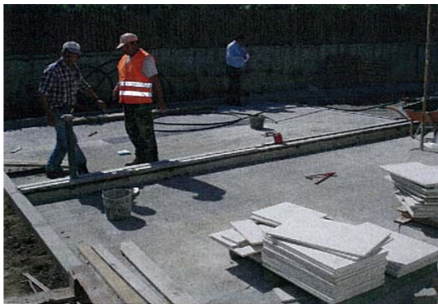
Fig.25 – Canal de recolha de águas
