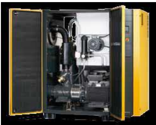
Figura 15 – Motor do compressor
